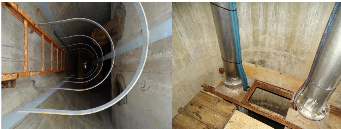
Le captage de Couthiol –vue plongeante du puits – colonnes montants des pompes en bas du puits
